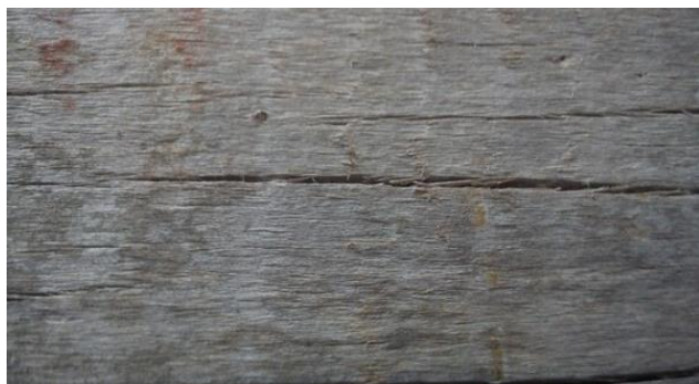
Figura 5. Fendilhamento superficial da madeira.
