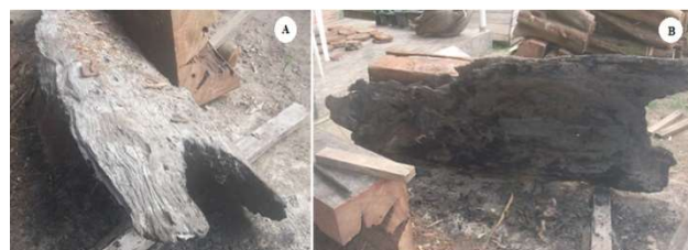
Figura 4. Peça de sucupira-preta com sinais de carbonização nas extremidades (A) e deterioração na parte inferior da peça (B).
