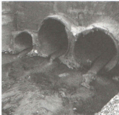
Figura 10: Entradas de esgoto no canal do córrego do Quartel.
