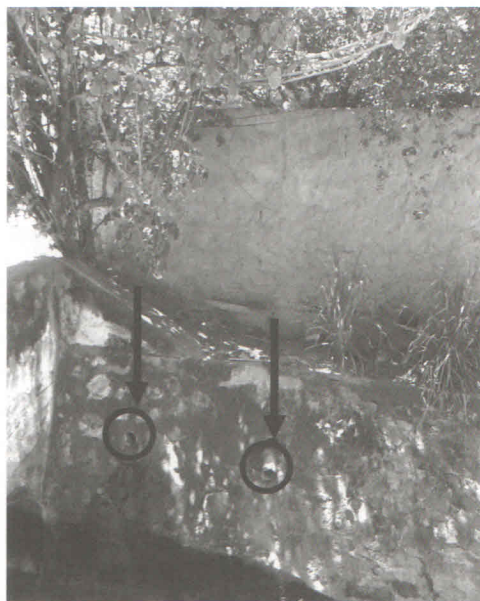
Figura 06: Entrada de esgoto no canal do córrego Mãe Bonifácia na Praça João Balduino Curvo, no Bairro do Quilombo. Foto: Alexandre da Silva (Nov./2008).
