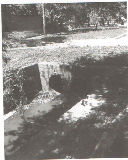
Figura 05: Canalização da nascente do Córrego Mãe Bonifácia ou "do Caixão" na Praça João Balduino Curvo no bairro do Quilombo.
