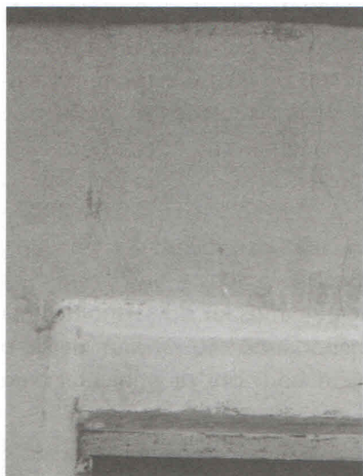
Figura 16 – Fissura acima da janela. Foto: Julia Martinaitis Gonçalves
