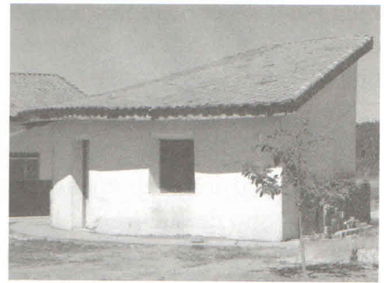
Fig.15–jun. de 2006, após chuvas, com reboco protegidas das chuvas com lona e cobertura.
