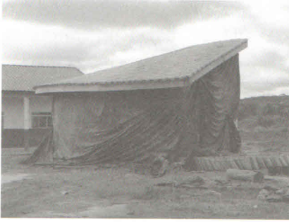
Figura 14 – jan. de 2005, paredes sem reboco.
