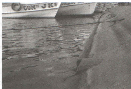
Figura 4: Lançamento de esgoto in natura - Santarém Foto: Luiz Gonzaga Toledo, 2006
