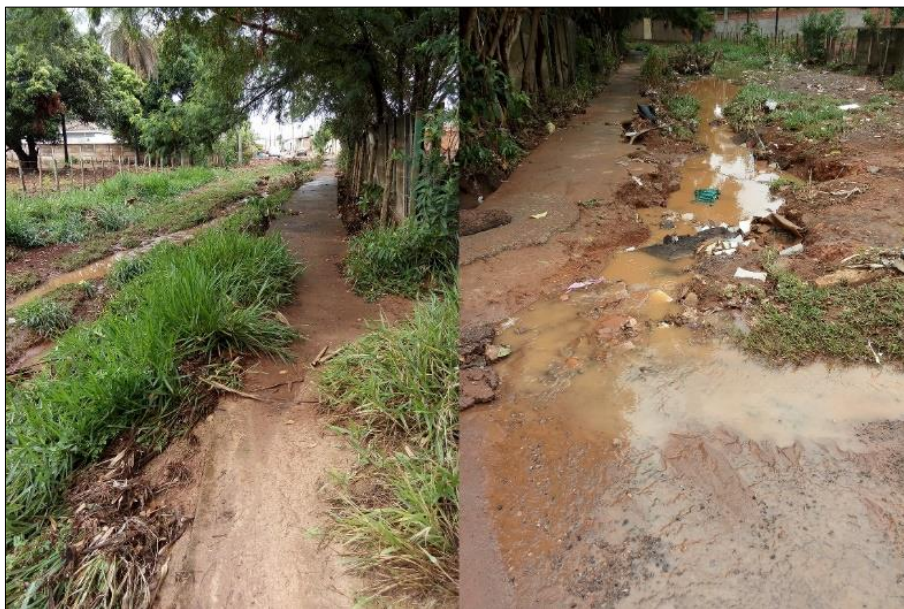
Figura 4. Na imagem à esquerda, é possível ver a vegetação deitada devido ao grande volume de água. Na imagem à direita, em posição acima de onde está a galeria, nota-se a forte erosão.
