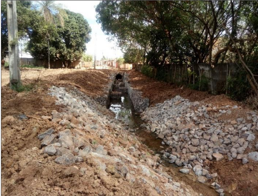
Figura 2. Canal de escoamento da galeria de água pluvial na parte leste da Mata da Bica. Fonte: Alex Oliveira (2018).
