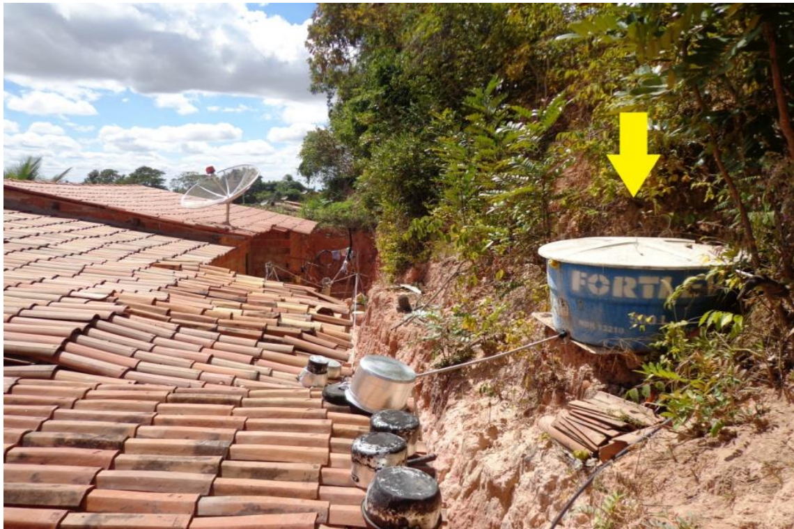
Figura 5 - Caixa d'água assentada no talude sob risco de queda e atingimento de moradia Fonte: Silva (2017)
