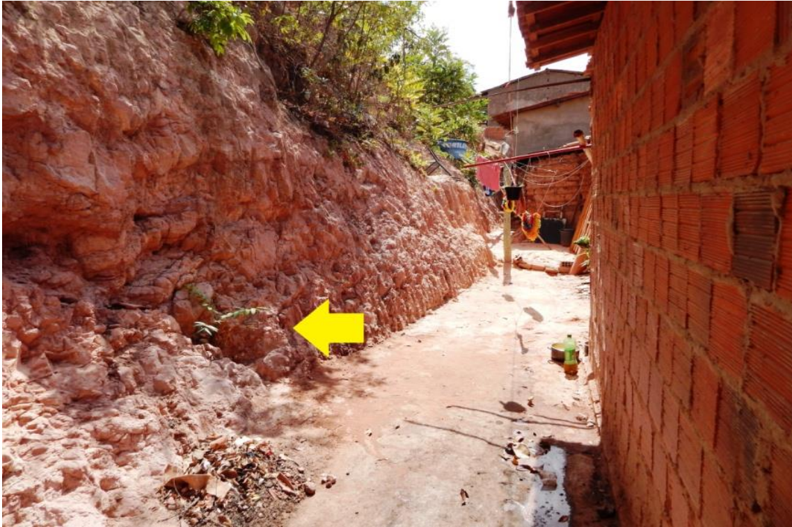
Figura 4 - Base do talude sem sustentação Fonte: Silva (2017)
