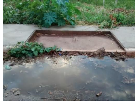
Figura 27 - Boca de lobo obstruída com resíduos
