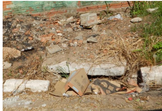
Figura 9 - Boca de lobo com resíduos
