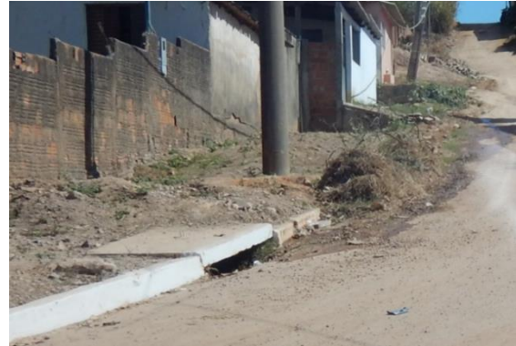
Figura 12 - Sedimentos obstruindo a sarjeta
