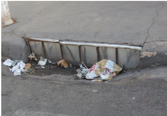
Figura 8 - Boca de lobo obstruída
