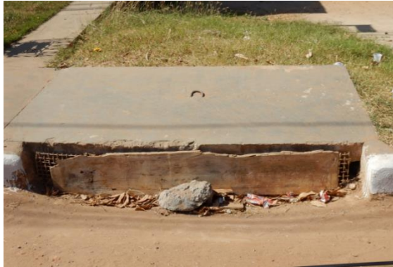
Figura 11 - Obstrução da boca de lobo
