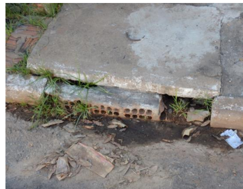
Figura 15 - Boca de lobo bloqueada por tijolos
