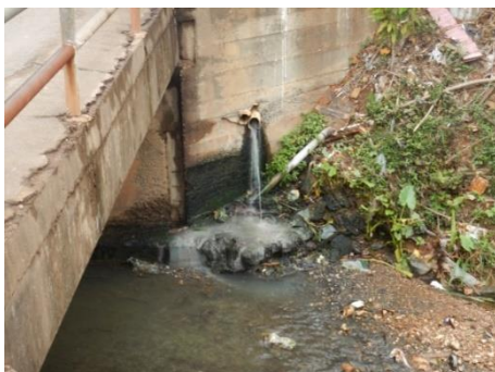
Figura 21 - Lançamento de esgoto doméstico
