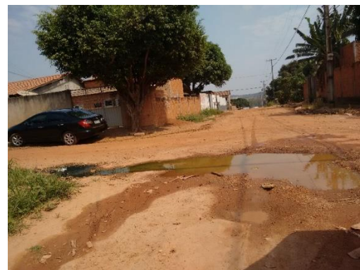
Figura 4 - Ponto de alagamento
