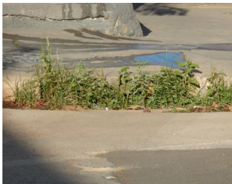
Figura 14 - Boca de lobo obstruída com vegetação
