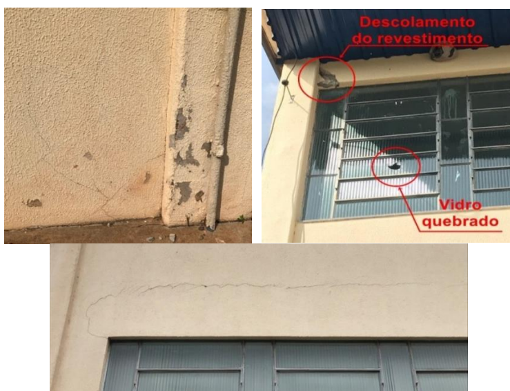
Figura 11 – Incidência de fissuras e descolamentos no acabamento, descolamento do revestimento e vidro quebrado
