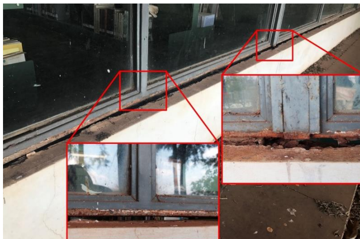
Figura 6 – Descolamento entre esquadria e alvenaria, na fachada da biblioteca
