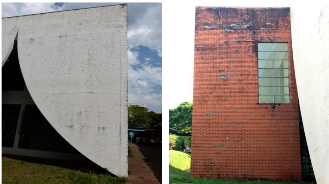
Figura 5 – Incidência de fissuras, bolor e descolamento do revestimento cerâmico
