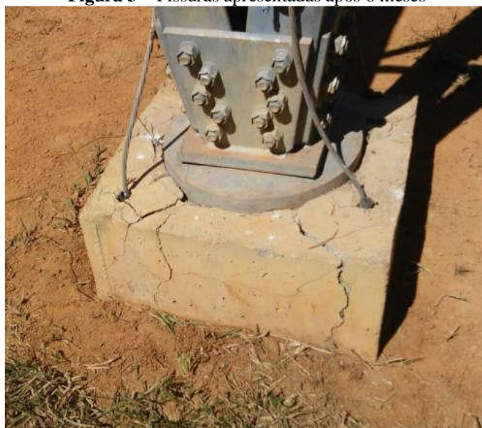
Figura 3 – Fissuras apresentadas após 6 meses
