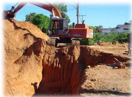
Figura 3 – Vala com profundidade maior que 1,8m, sem observância das normas de Segurança.
