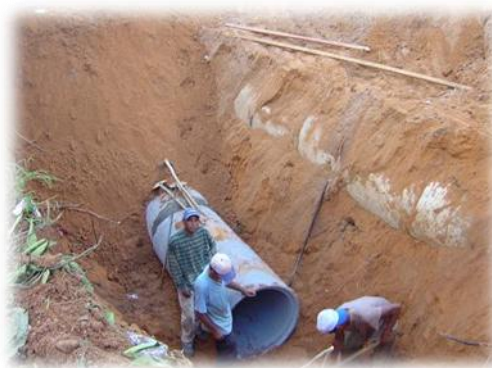
Figura 5 – Colocação de dutos sem observância das normas de Segurança
