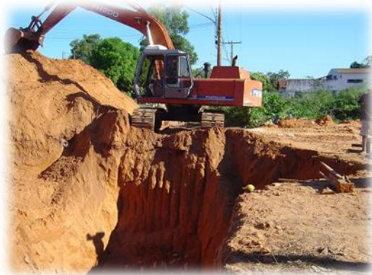
Figura 4 – Vala com profundidade maior que 1,8m, sem observância das normas de Segurança.
