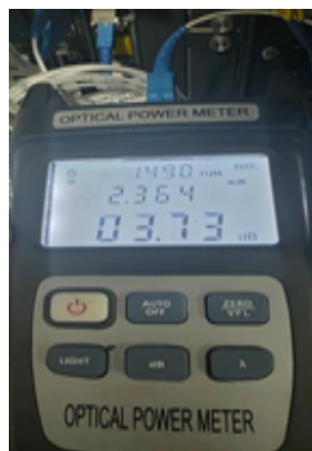
Figura 6 – Medição da potência óptica na saída da OLT EPON.
