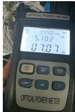
Figura 7 – Medição da potência óptica na saída da OLT GPON.
