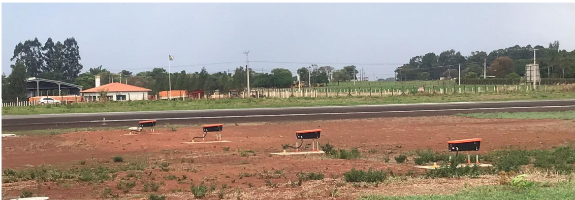
Figura 8 - Sistema PAPI instalado no Aeroporto de Rio Verde
