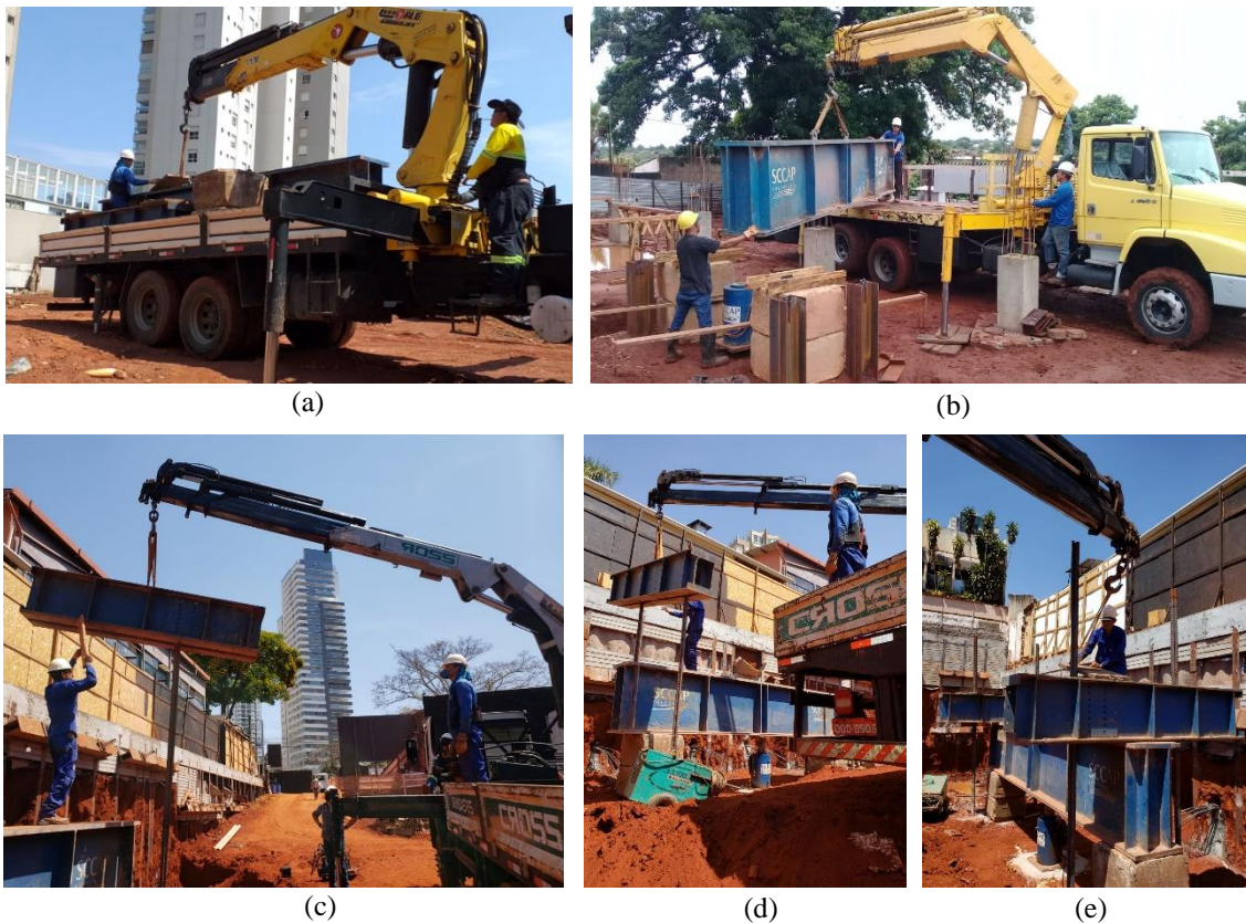
Figura 4 – Montagem do sistema de reação: (a) chegada material em caminhão Munck; (b) movimentação da viga principal; (c) movimentação da 1ª viga secundária; (d) movimentação da 2ª viga secundária; e (e) movimentação das chapas de travamento.
