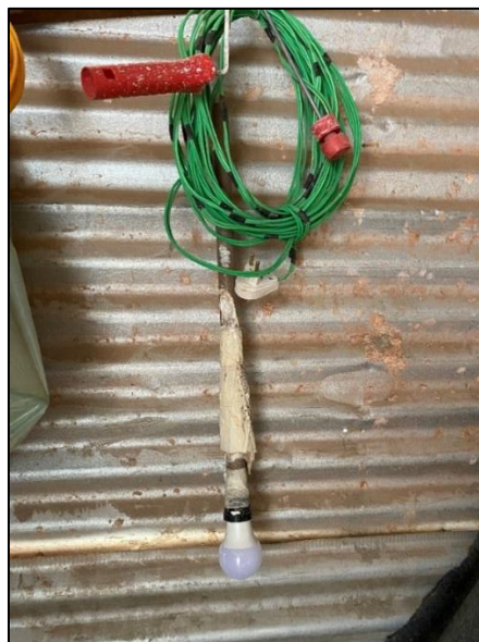
Figura 7 - Iluminação provisória - Obra 1.
