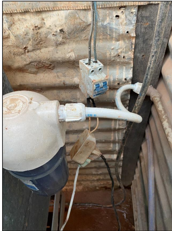
Figura 3 - Instalação inadequada - Obra 1.
