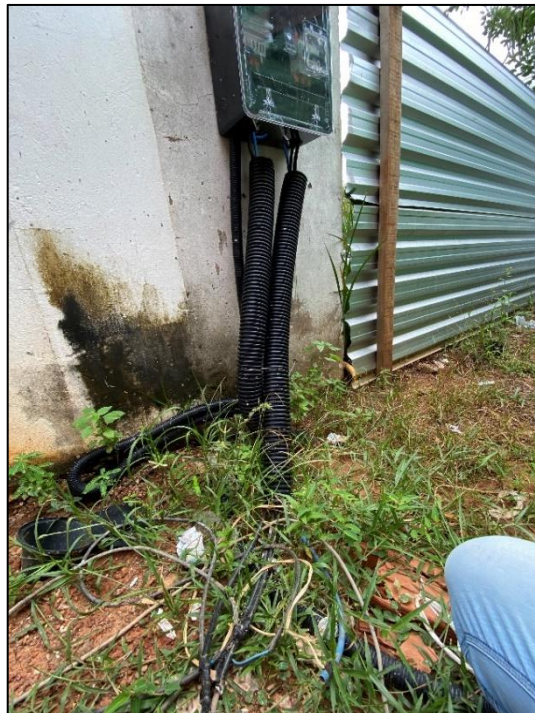
Figura 2 - Derivação do quadro de medição - Obra 9.
