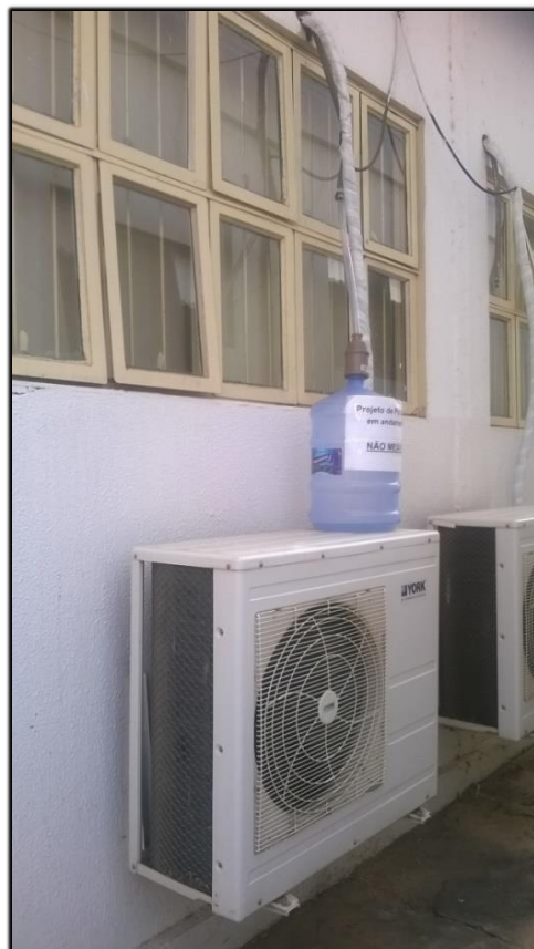
Figura 2. Aparato de coleta de água do ar condicionado em estudo no IFMT, campus Cuiabá-Bela Vista. Fonte: Autores.
