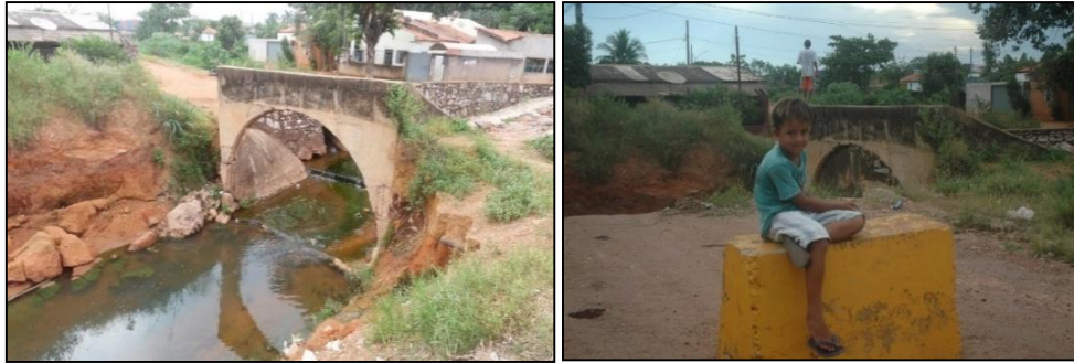
FIGURAS 15,16- Córrego Bambu – esta área traz lembrança de um ambiente pós-guerra, especialmente após a destruição da ponte que aconteceu após um período de enchente, há mais ou menos um ano e meio atrás. Crianças brincando em meio ao processo de degradação sócio-ambiental da área onde o Córrego Marimbondo 1 desagua no Córrego Bambu. Foto: A. A. P. Maio/2016.
