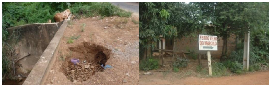
FIGURAS 6 e 7 - Córrego Canivete – Jd. Assunção II Parte, ponte da Rua Maria José Ribeiro de Oliveira, antiga Rua 05, observamos processos de degradação com deposição de esgoto e lixo a céu aberto. Observamos também construções antigas em área de Preservação Ambiental. Foto: A. A. P., Maio/2016.
