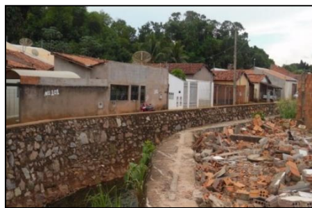
FIGURA 17- Córrego Bambu – pode-se observar que o processo de canalização ainda não foi concluído e também visualizamos a proximidade das construções, com vias de acesso onde transitam somente um veículo por vez. Foto: A. A. P. Maio/2016.
