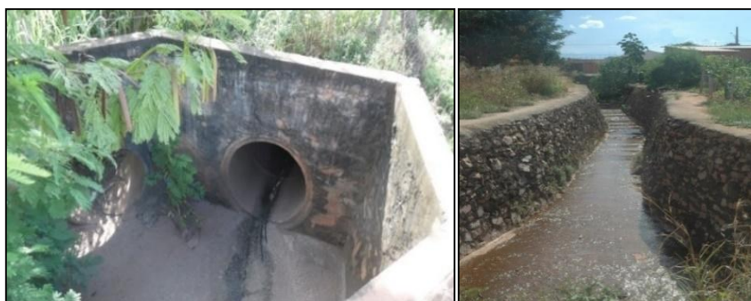
FIGURA 9 e 10- Jd. Tropical – Córrego Canivete- a moradora nos relatou que em um primeiro momento, durante o processo de canalização naquele local, foram construídas manilhas baixas e direcionadas às construções e que durante a primeira chuva aconteceu a derrubada da contenção o que ocasionou inundações e até um acidente onde uma moto caiu no córrego neste ponto. Foto: A. A. P., Maio/2016.
