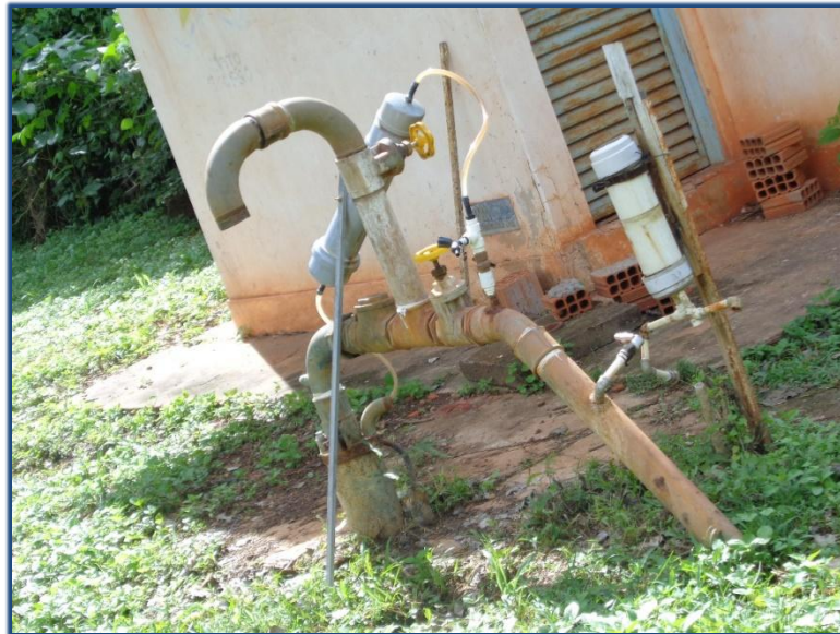
Figura 9 – Clorador denominado de chupa cabra instalado na estrutura do PT 06. (Fonte: Acervo dos autores)
