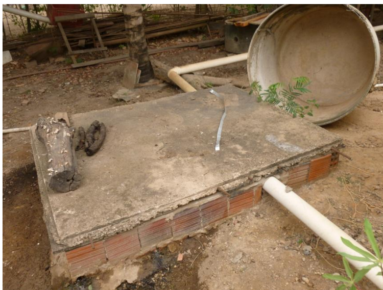
FIGURA 5. Fossa rudimentar contaminando o solo I (Fonte: Registros feitos durante as entrevistas na comunidade).
