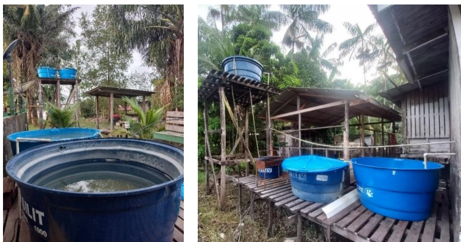
FIGURA 6 – Sistema de captação de água da chuva em residência no Bailique
