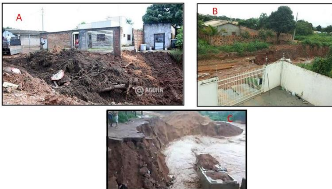
Figura 4. Avanço do processo erosivo sobre as residências em período chuvoso. A e B: registros de reportagem sobre risco de desabamento das residências. C: registro da proximidade da voçoroca com as residências durante a chuva em 2019; nota-se estruturas de drenagem urbana tombadas por efeito da retomada erosiva.
