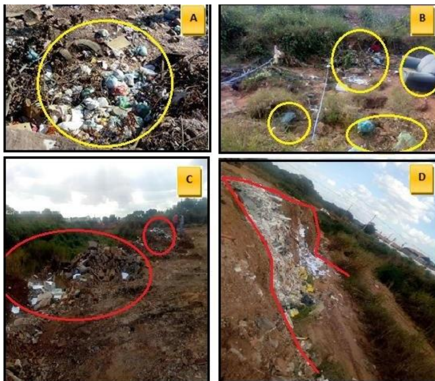
Figura 3. Resíduos sólidos jogados e colocados no interior do processo erosivo como tentativa de contenção de seu avanço. A: resíduos orgânicos domésticos. B: resíduos sólidos e orgânicos domésticos. C e D: resíduos sólidos colocados pela prefeitura no talude.
