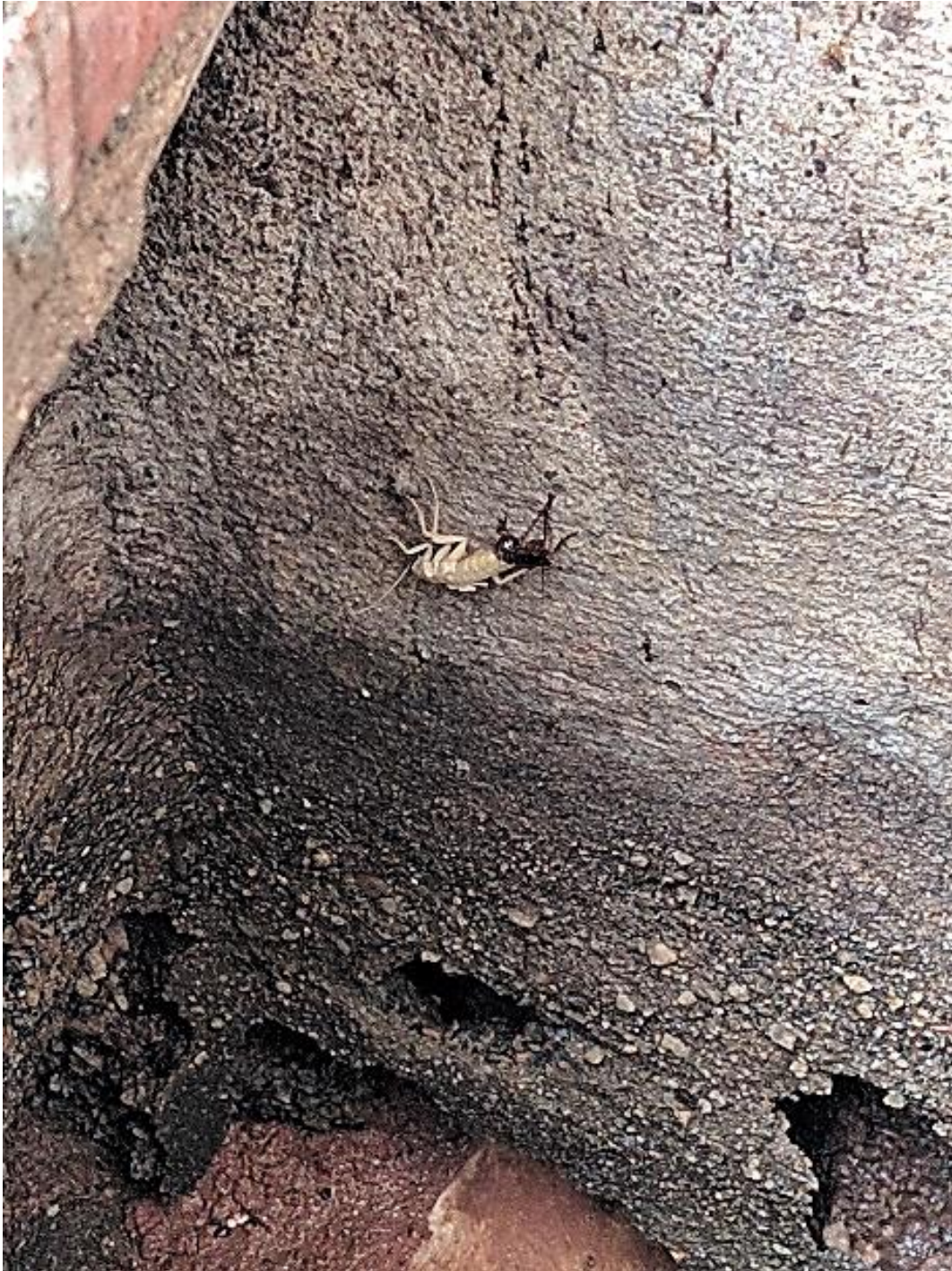
Figura 5. Baratas-domésticas ( Periplaneta americana ) dentro da caixa de gordura.
