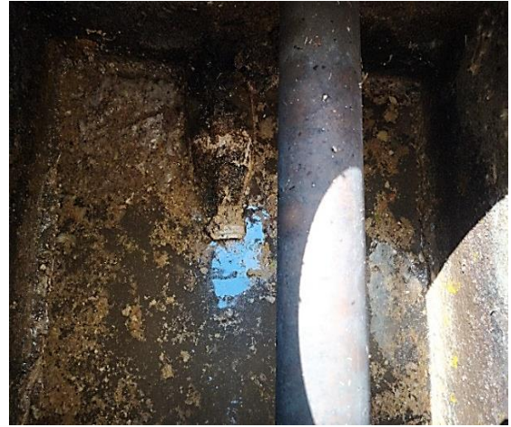
Figura 3. Caixa de gordura antes da limpeza.
