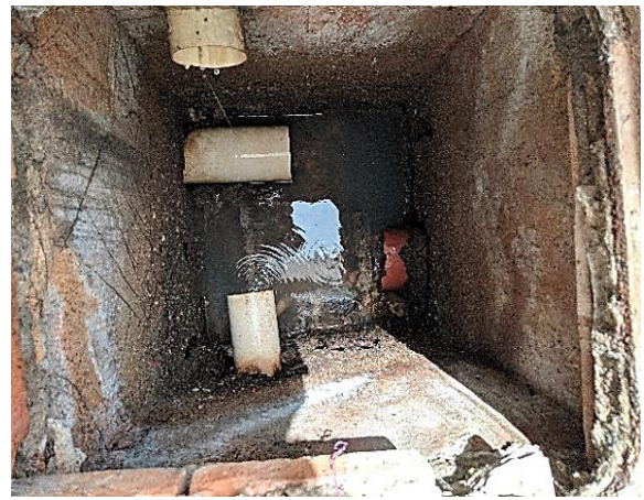
Figura 4. Caixa de gordura após a limpeza.
