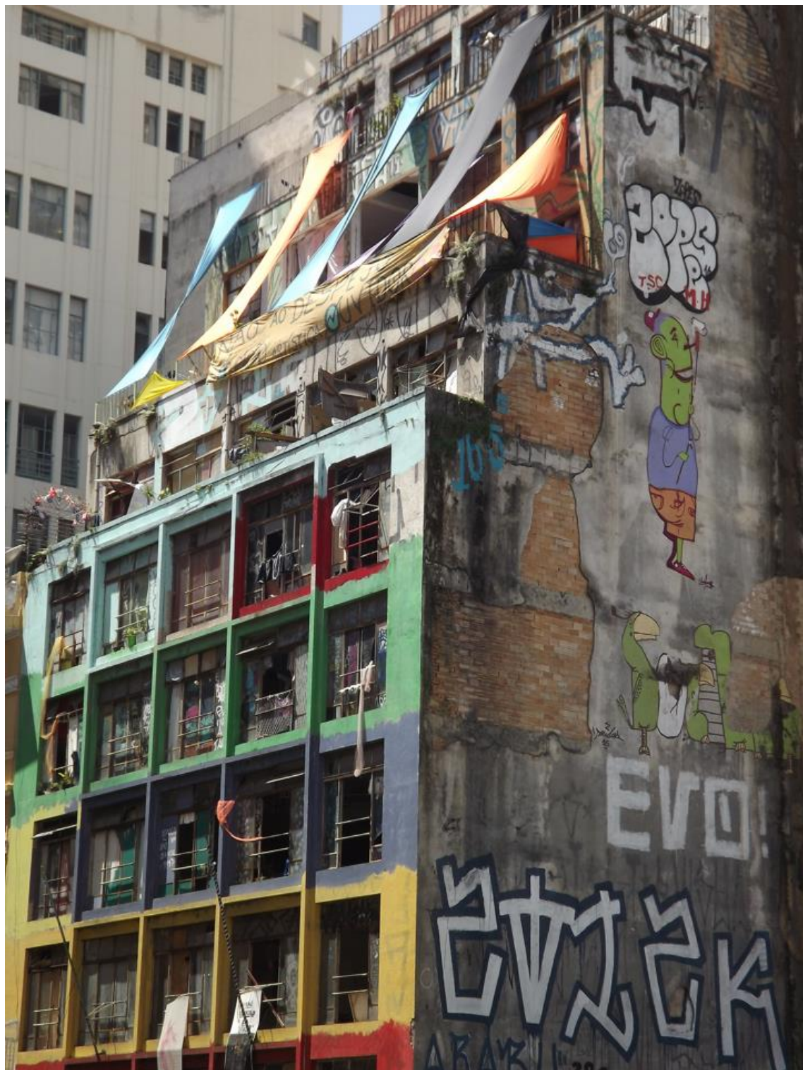
Foto 8 – Edifício localizado na rua do Ouvidor, já mencionado neste ensaio fotográfico (ver legenda 5). As características da fachada são similares àquelas descritas no edifício Prestes Maia (ver legenda 2). Como a deterioração descasca a pintura e o reboco, é possível interpretar o sistema construtivo adotado. Na lateral, vê-se estrutura de pilares e vigas de concreto armado moldada in loco . O fechamento é de alvenaria de tijolos, sem função estrutural. A partir de certos condicionantes, como materiais e sistema construtivo, mais o arranjo espacial interno e o nível de deterioração material, é possível projetar as condições para uma eventual reabilitação futura, em termos espaciais, construtivos e econômicos, verificando a viabilidade da operação. Grandes planos envidraçados, por exemplo, como os que se observam na foto, ajudam o posicionamento de janelas dos cômodos domésticos que seriam concebidos; as paredes laterais construídas no limite do terreno, no entanto, impedem aberturas nessa fachada (28 setembro 2016).
